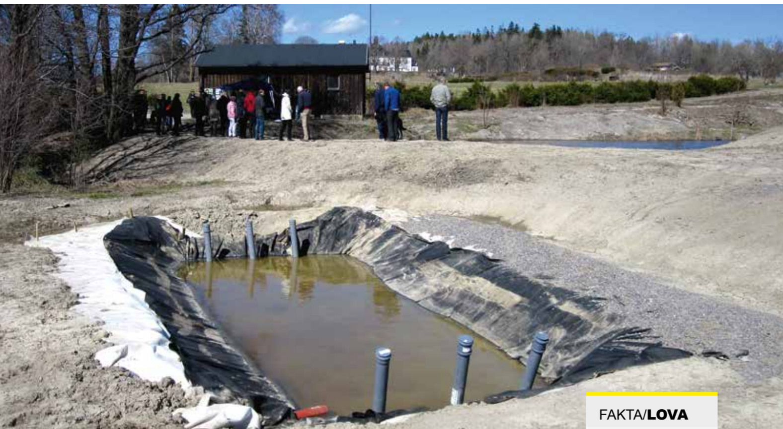
Nyanlagd fosfordamm vid Öknaskolan med tillhörande kalkfliter (närmast i bild).
